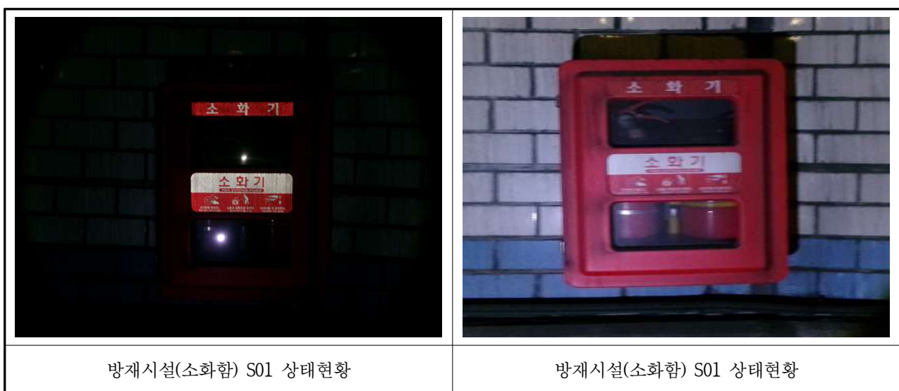
【사진 3.4.17】 방재시설 손상현황
