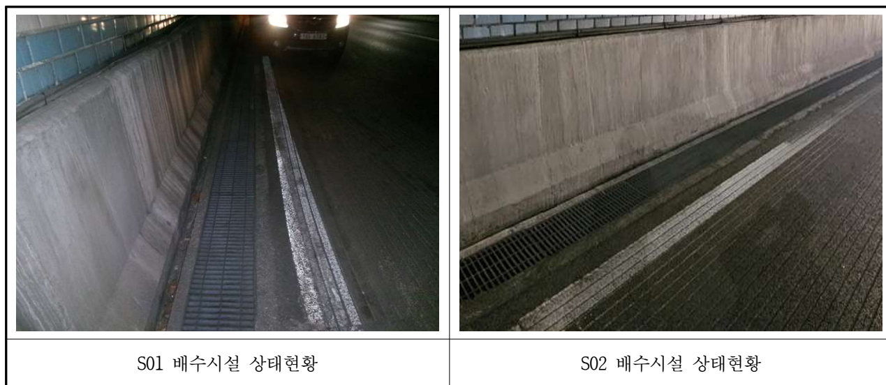
【사진 3.4.12】 배수시설 손상현황
