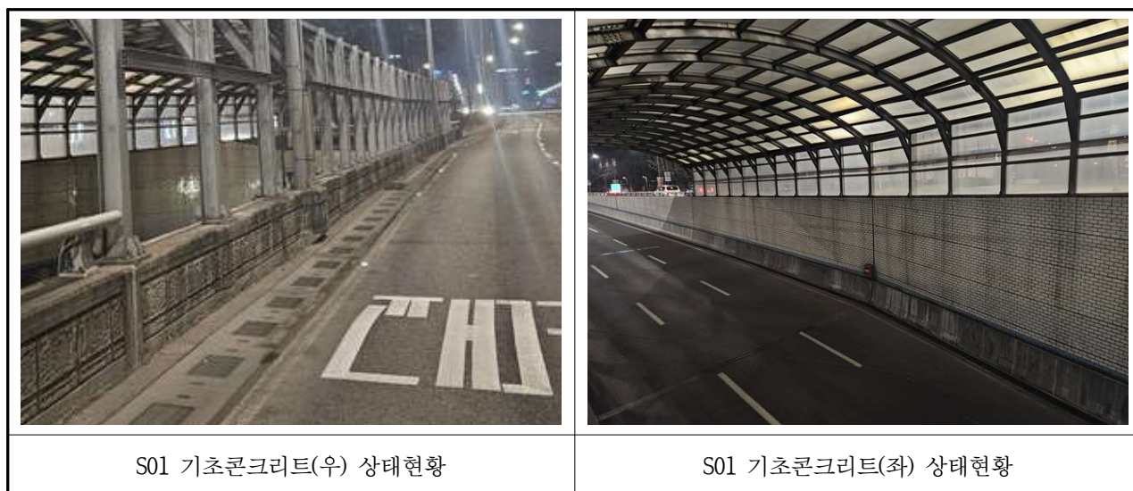
【사진 3.4.8】 기초콘크리트 손상현황
